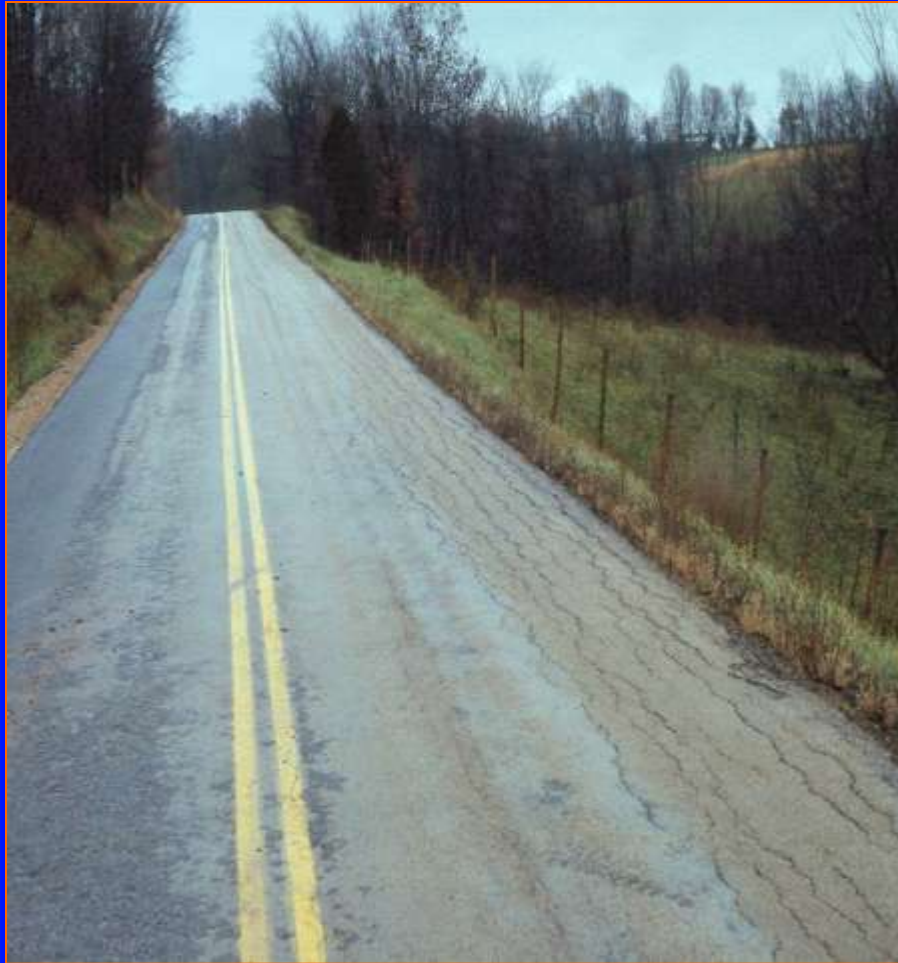
Fatigue cracking due to edge failure
